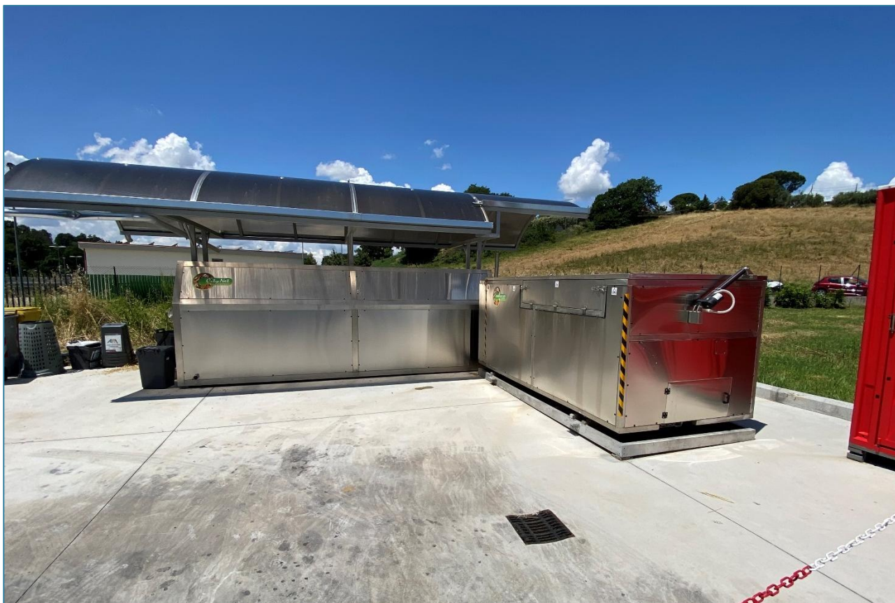
Figura 39 Compostiera elettromeccanica installata in un'area attigua CCR
